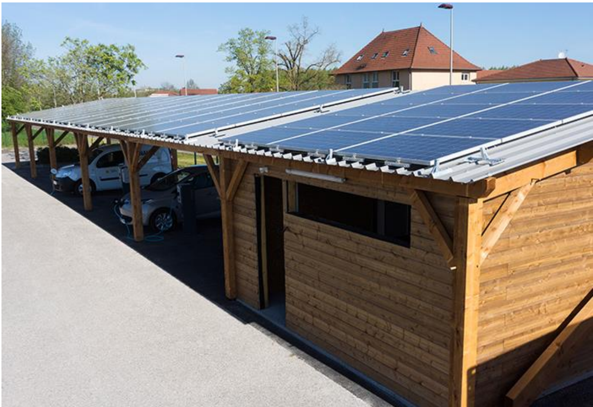
Ombrière photovoltaïque pour véhicules électriques en autoconsommation. Crédits : EDF ENR
