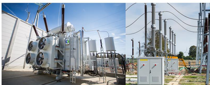
Le poste électrique intelligent de Blocaux (50km d'Amiens)
