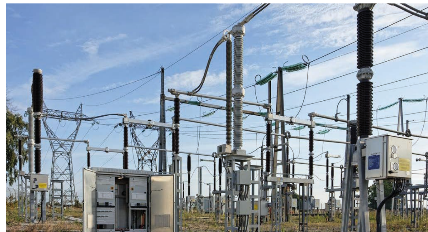
RTE poste électrique intelligent blocaux
