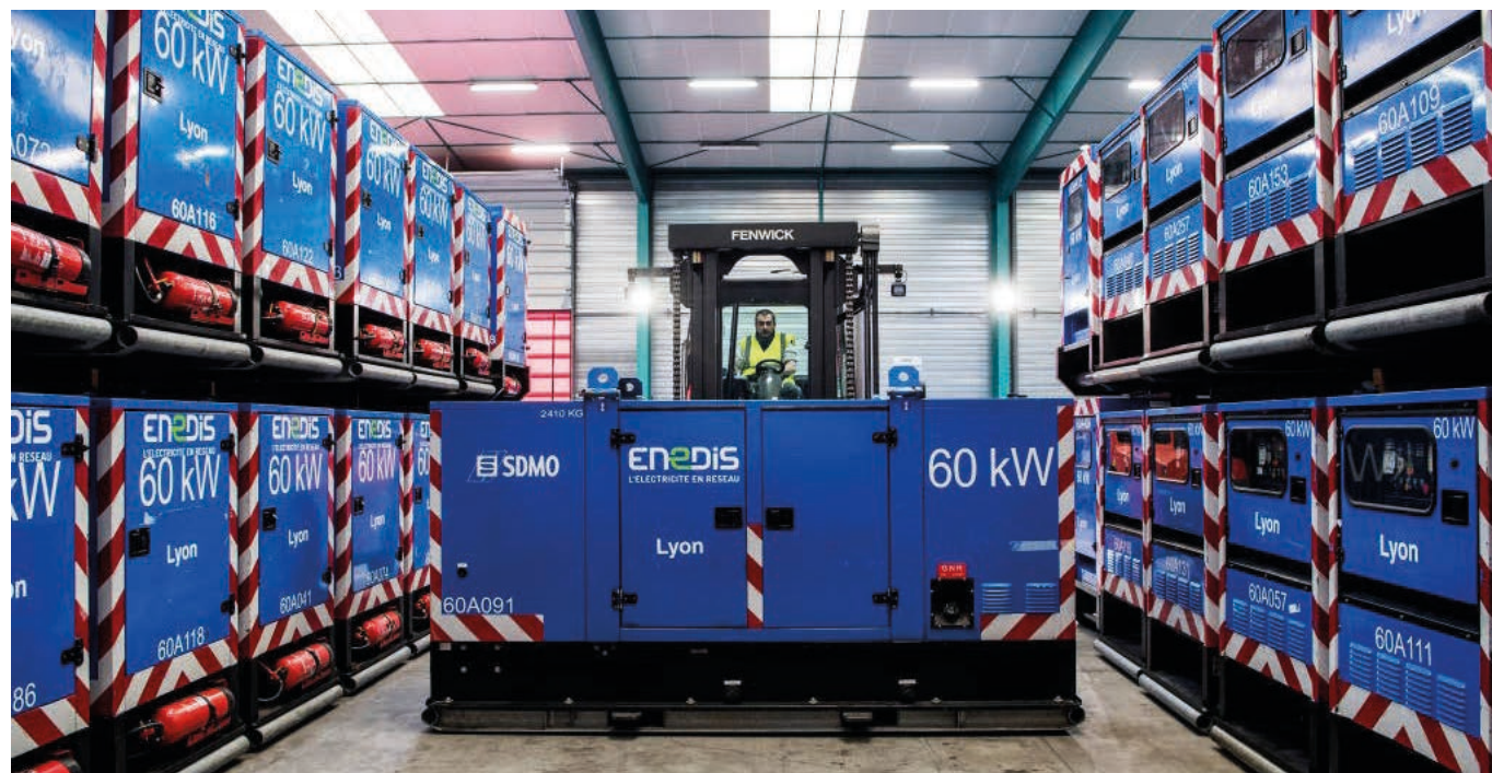
Entrepôt de stockage de batteries Enedis
